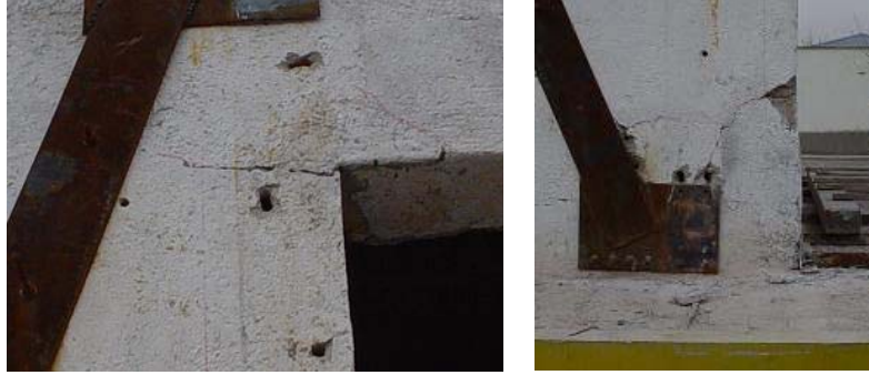
Şekil 6. Dördüncü Deney Sonrası Gelişen Çatlaklar
