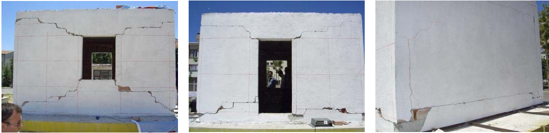
Şekil 5. Hasarlı Deney Yapısının Test Sonrasında Görünüşü
